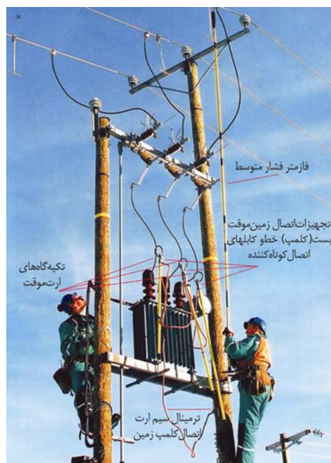
شکل ۱۲- تکیه گاه های اتصال ارت موقت در جمپر ترانس هوایی و نحوه ارت موقت ایمنی
